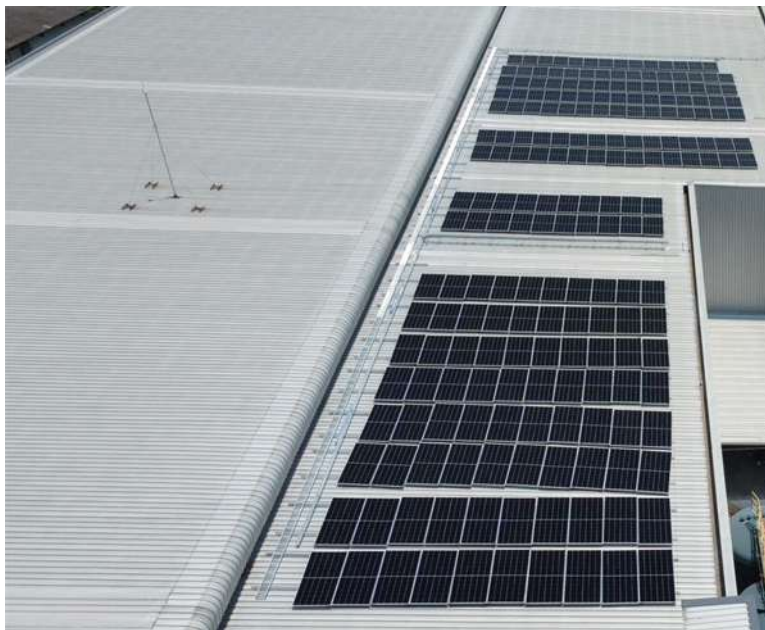
แผงโซลาร์เซลล์ที่ติดตั้ง ณ คลังสินค้าอ้อมใหญ่
